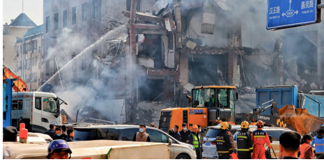
与北京相邻的河北三河燕郊镇迎宾路一栋楼房3月13日上午突然爆炸，附近多栋建筑受损严重。
